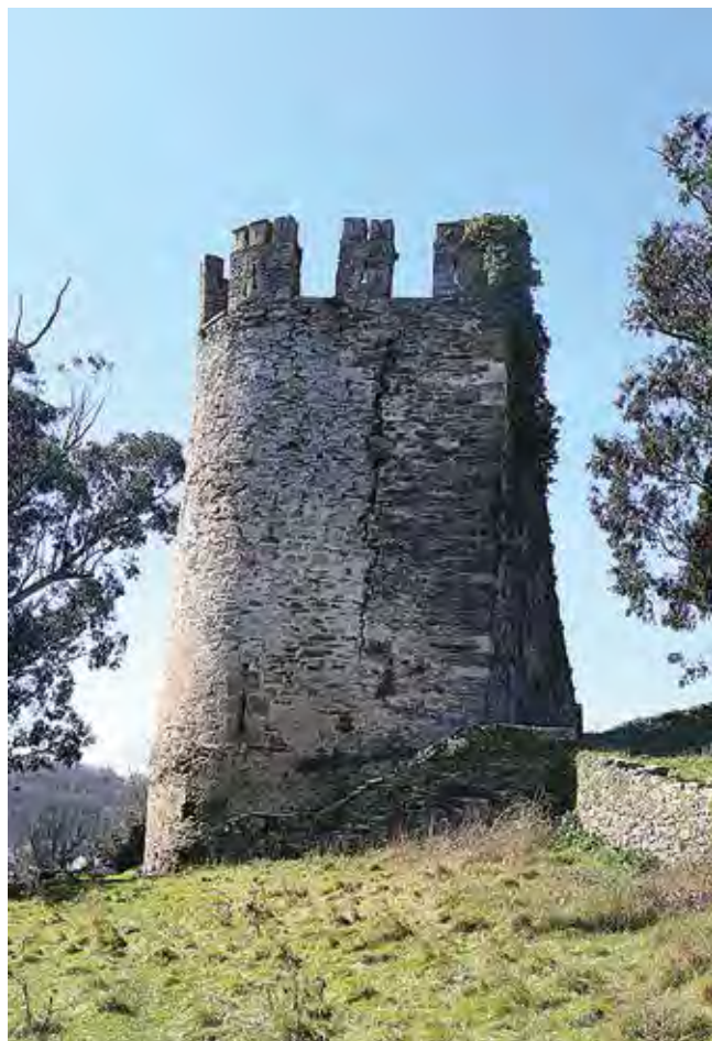
Torre de la fortaleza de Sarria, observese la gran grieta y el desplome del muro
