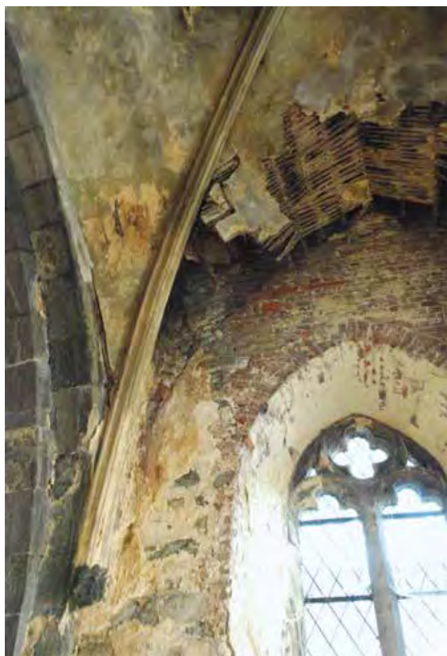
Dégâts visibles des voûtes
